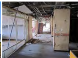
内部の被災状況
