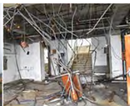
内部の被災状況
