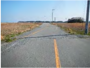
①地震・津波により舗装のズレが生じた町道両竹・請戸線
